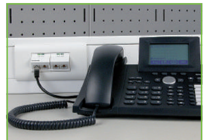
Téléphone IP directement connecté au switch
