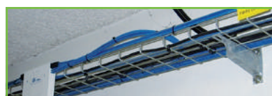
Pas de chemin de câbles dédié
